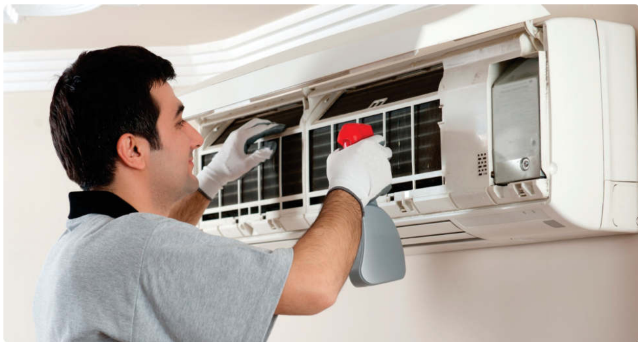
SERVIÇO ESPECIALIZADO EM INSTALAÇÃO, MANUTENÇÃO E HIGIENIZAÇÃO DE AR CONDICIONADOS E BEBEDOUROS INDUSTRIAIS
